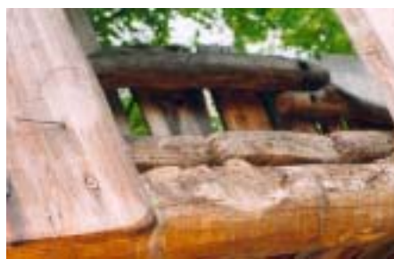
Abbildung 2: Brücke mit vorstehenden Nägeln
