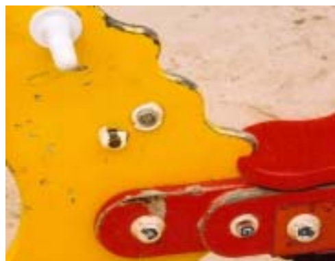
Abbildung 8: Fehlende Handgriffe an Wippgerät
