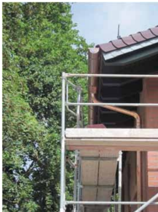
Abbildung 35: Das Gerüst am Unfalltag
