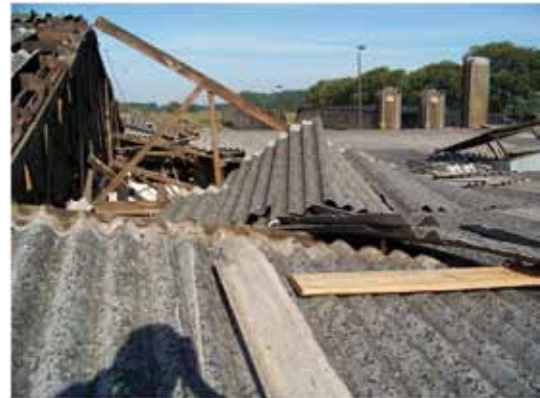
Abbildung 20: Das eingestürzte Dach
