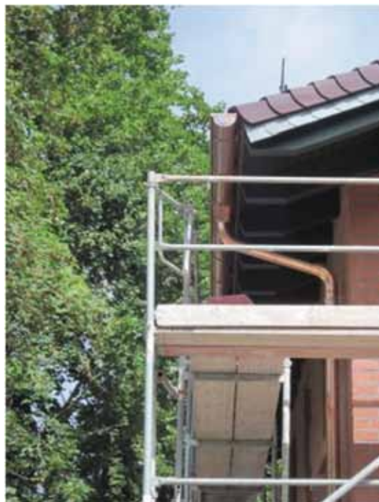
Abbildung 35: Das Gerüst am Unfalltag
