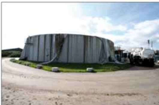
Abbildung 6: Der beschädigte Behälter
