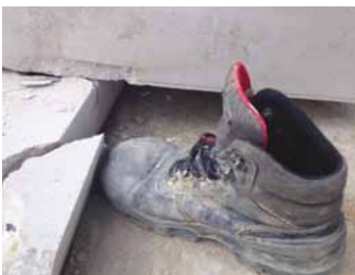
Abbildung 28: Beschädigte Aufnahmeöffnung am KS-Stein
