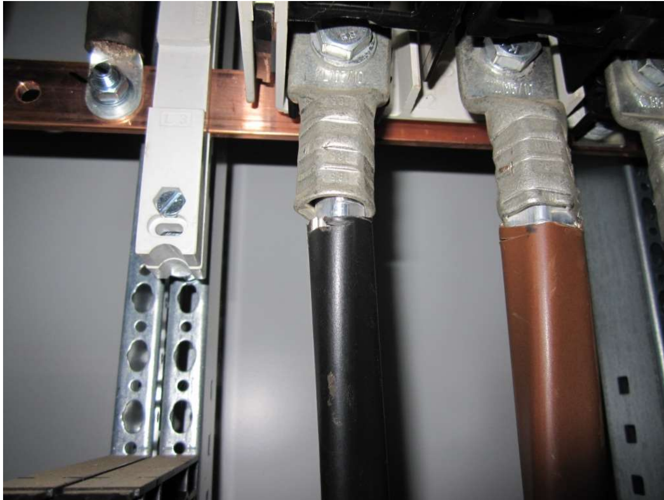
Mangelhaft ausgeführte Klemmverbindung
