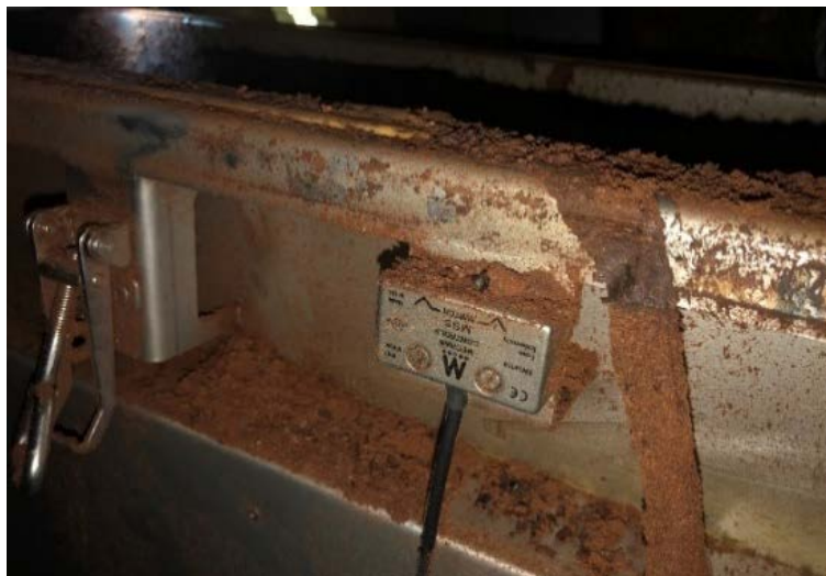
Abb. 18: unzugängliche Seite der Transportschnecke mit unterem Teil des Sicherheitskontaktschalters
