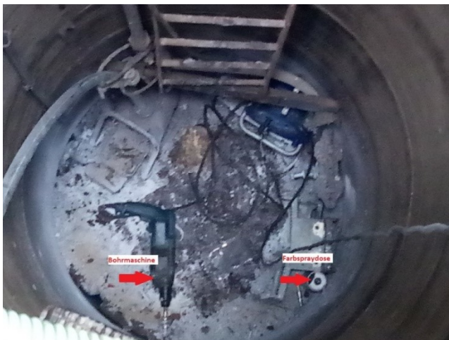
Abbildung 17: Schacht mit Farbspraydose
