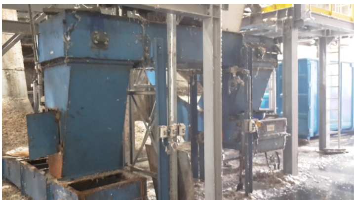
Abbildung 18: Verteilerkratzkette (waagerechter oberer Aufbau) mit linkem und rechtem Trichterabgang
