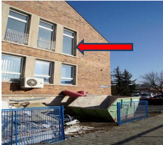
Abbildung 26: Fenster mit abgestürzter Schuttrutsche
