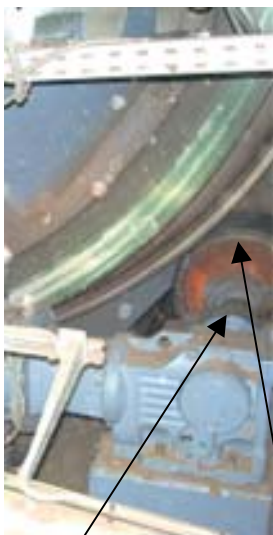
Abbildung 50: Siebtrommel: Fehlende Schutzeinrichtungen
