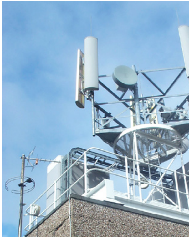
Abbildung 10.1 – Mobilfunksektorantenne und Parabolantenne auf dem Dach des Aufzugsschachts
