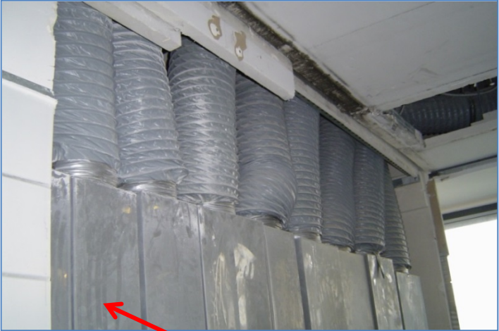
Sichtbare Vibrationen an den Kanalverkleidungen
