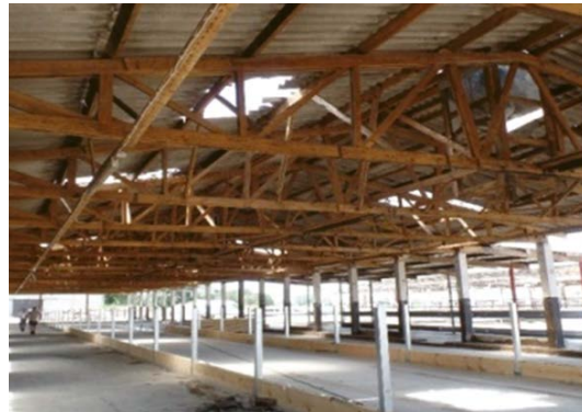
Abbildung 30: Dachfläche mit Durchbruchstelle
