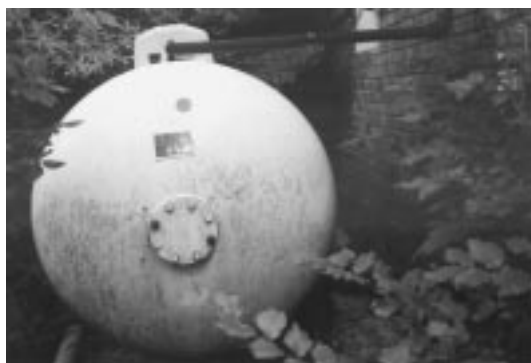
Abbildung 17: Der Behälter in Schiefelage
