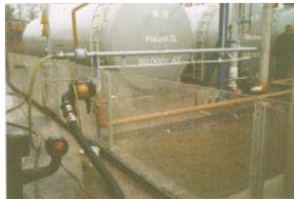
Abbildung 14: nicht ableitfähige Plexiglas-Spritzschutzwand innerhalb der Zone 1
