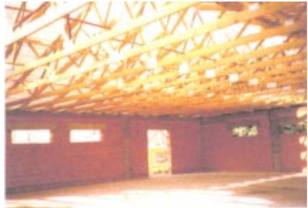
Abbildung 20: Deckenkonstruktion ohne Absturz-sicherung
