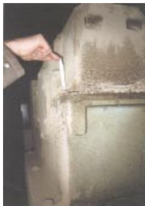
Abbildungen 10 und 11: starke Staubablagerungen z. B. auf Maschinen und Treppengängen
