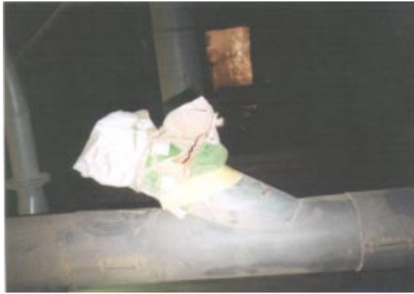
Abbildung 8: Behelfsmäßig abgedichtete Rohrleitungsabzweigung
