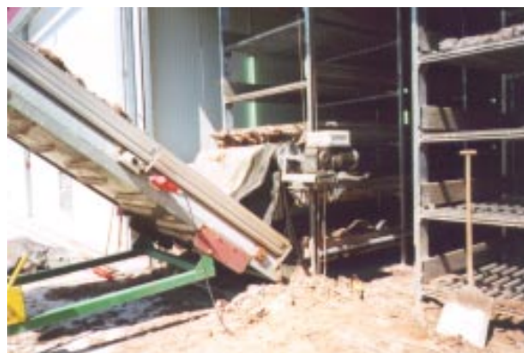
Abbildung 26: mit Not-Aus-Tastern nachgerüstete Winde
