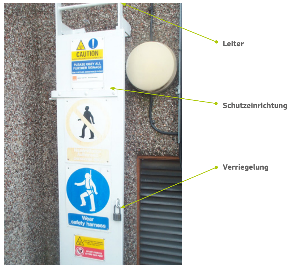
Abbildung 9.2 Verwendung einer Leiter-Schutzeinrichtung zur Beschränkung des Zugangs zu starken Feldern auf einem Dach
