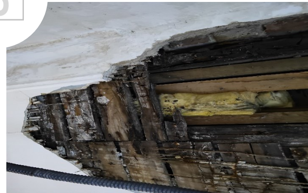
Schimmel- und Feuchteschäden
